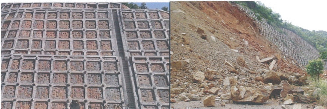
图 D. 1-17、图 D. 1-18 边坡支护及垮塌
