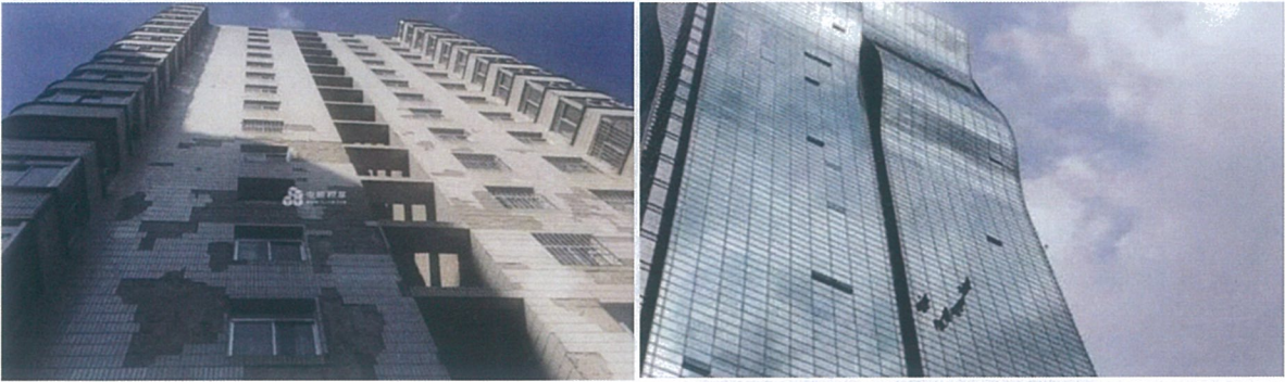
图 D. 4-1 外墙立面瓷砖脱落、图 D. 4-2 外墙立面玻璃幕墙脱落
