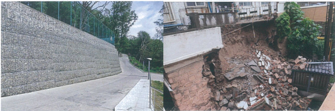
图 D. 1-15、图 D. 1-16 挡土墙及垮塌
