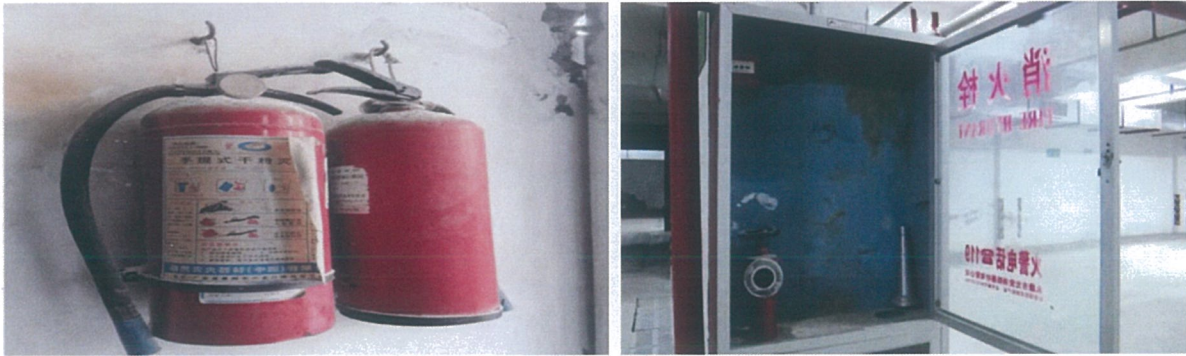
图 D. 5-5 过期的灭火器、图 D. 5-6 消火栓部件缺失
