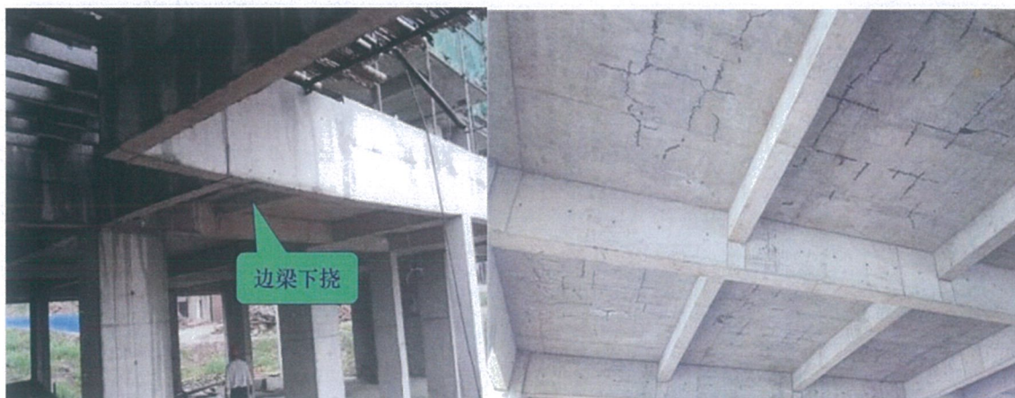
图 D. 3-5、图 D. 3-6 梁板下挠变形
