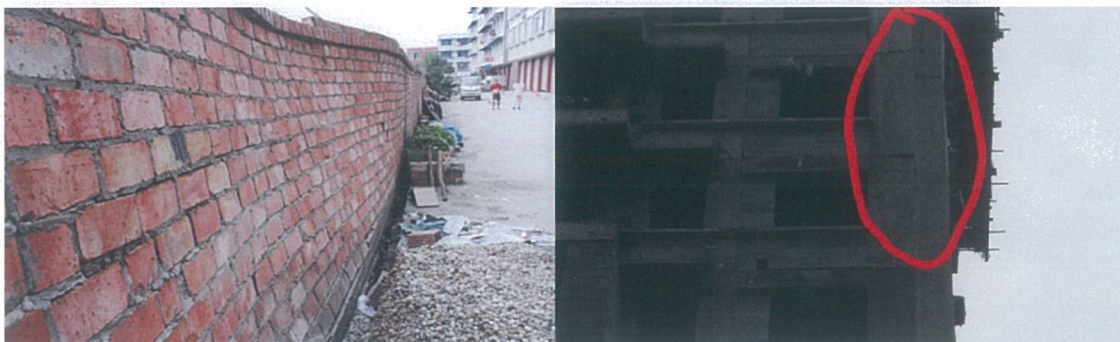
图 D. 3-3 围护墙明显倾斜、图 D. 3-4 柱明显倾斜
