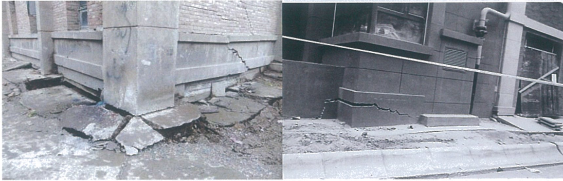
图 D. 2-1、图 D. 2-2 底层墙体存在明显斜裂缝
