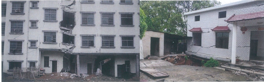
图 D. 1-7、图 D. 1-8 采矿区房屋下沉
