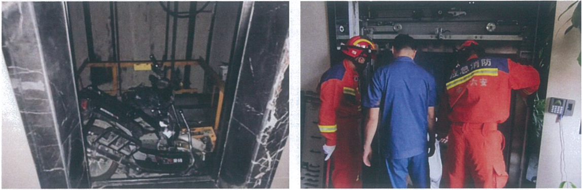
图 D. 6-3、图 D. 6-4 某小区坠落的电梯
